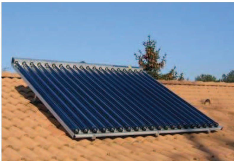
Figura 4. Ejemplo de panel solar térmico.
