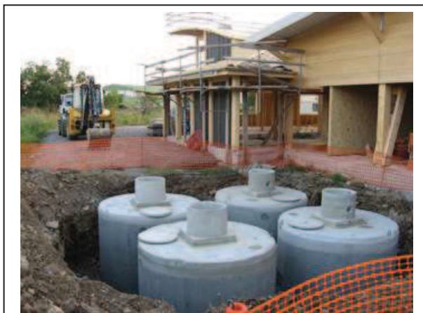
Figura 1. Cubas en hormigón (enterradas)
