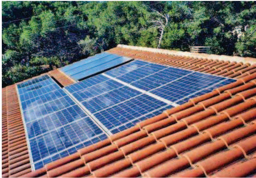
Figura 2. Ejemplo de paneles fotovoltaicos instalados.
