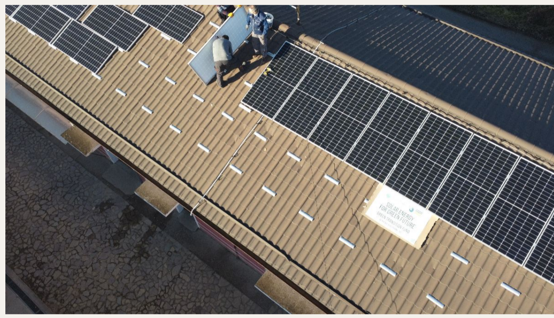
Leyenda: Proyecto del FIS-Emmaüs - Energía solar para un futuro verde, que dio lugar en 2022 a la instalación de paneles fotovoltaicos que producen más de 25 000kW de electricidad al año. | © FIS-EMAU
